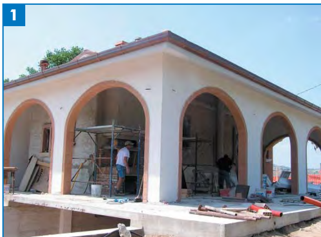
1 — VILLA DA RISTRUTTURARE ED ISOLARE.
